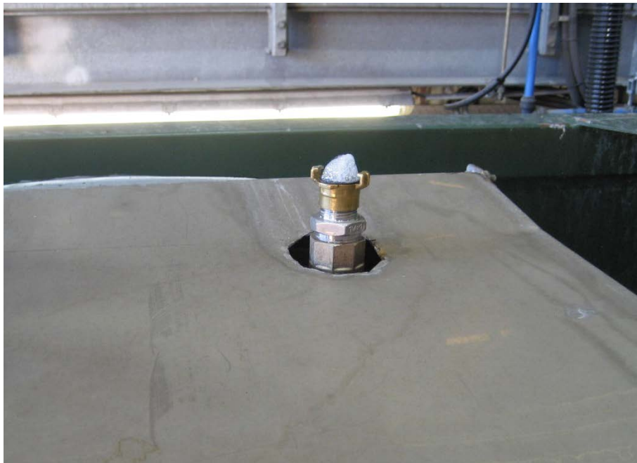
Image 4 : Tubulure de captage de gaz avec découpe de la couverture du caisson de dôme
