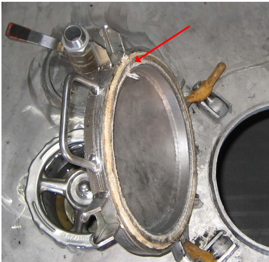
Image 2 : Joint endommagé d'un couvercle de dôme
