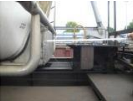
Bild 11: Detailansicht – Abstand Tankcontainer/Stützbock – hier: 20 cm
