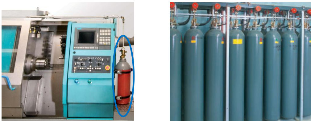
Bilder 4 und 5: In stationären Feuerlöschanlagen verwendete Gasflaschen
