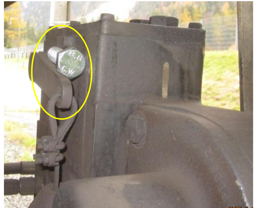
Straffseilhebel an hydraulischer Schnellschlusspumpe aufgespreizt, Aber: alle 4 Ventilstellungsanzeiger stehen auf ZU → Hydrauliköl wurde aus Leitungen entfernt!
