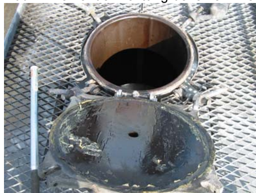
Abb. 4: Fehlende Dichtung bei einem Mannlochdeckel
